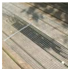
▲以前のウッドデッキは、施工して10年も経つと基礎から朽ちてしまい、床の一部に穴が開いた状態に。落ちないように上に網が被せてあった。
